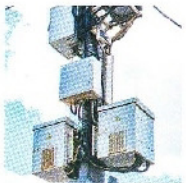
Базовая станция сотовой связи
